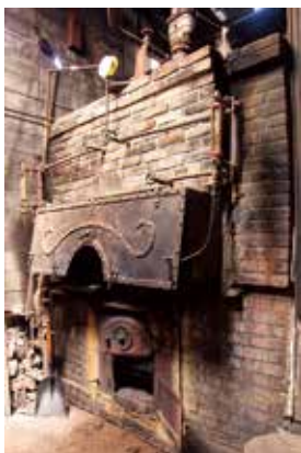
旧喜多製蠟ポイラー釜
