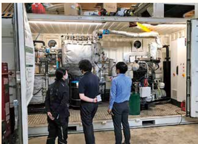
鳴子温泉エリアの小型CHP
