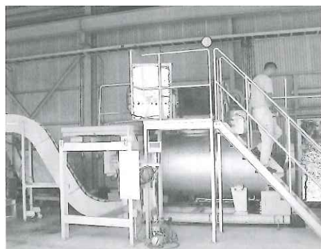
生ゴミ堆肥化プラント 「グリーンガイア」
