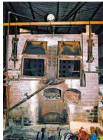
昭和初期か大正期か、ボイラー釜
