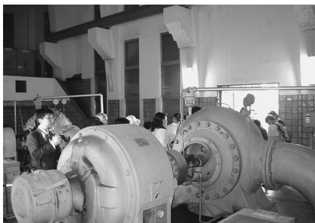
第一ポンプ所の室内
